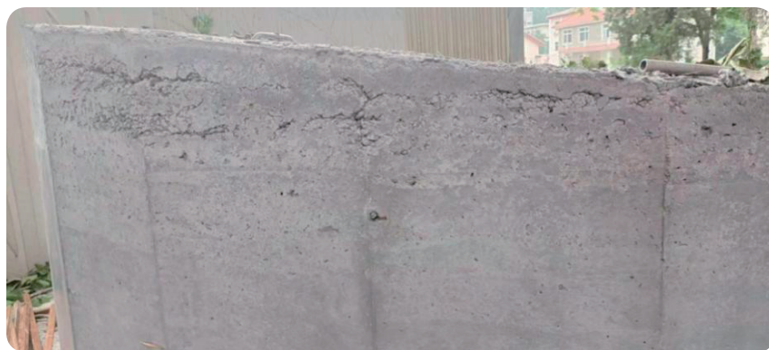
图4-10 圆柱截锥容器斜坡部分未充分振捣引起混凝土蜂窝麻面现象
