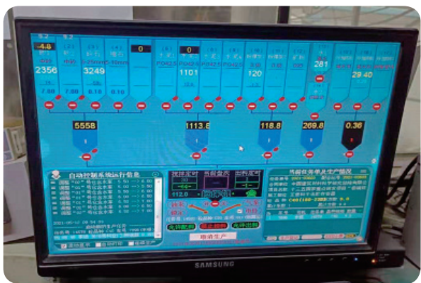
图4-6 搅拌站中控室混凝土原材料计量系统控制界面
