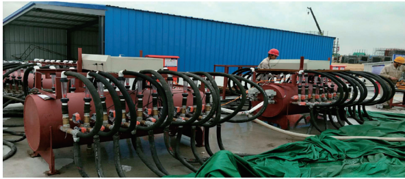
图8 CW1-3冷却水管自动控制系统实物图
